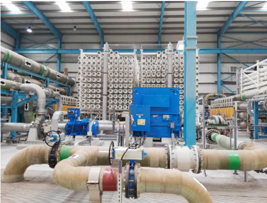
RO rack arrangement SALALAH IWP (Fisia Italmimpianti & Abengoa)
