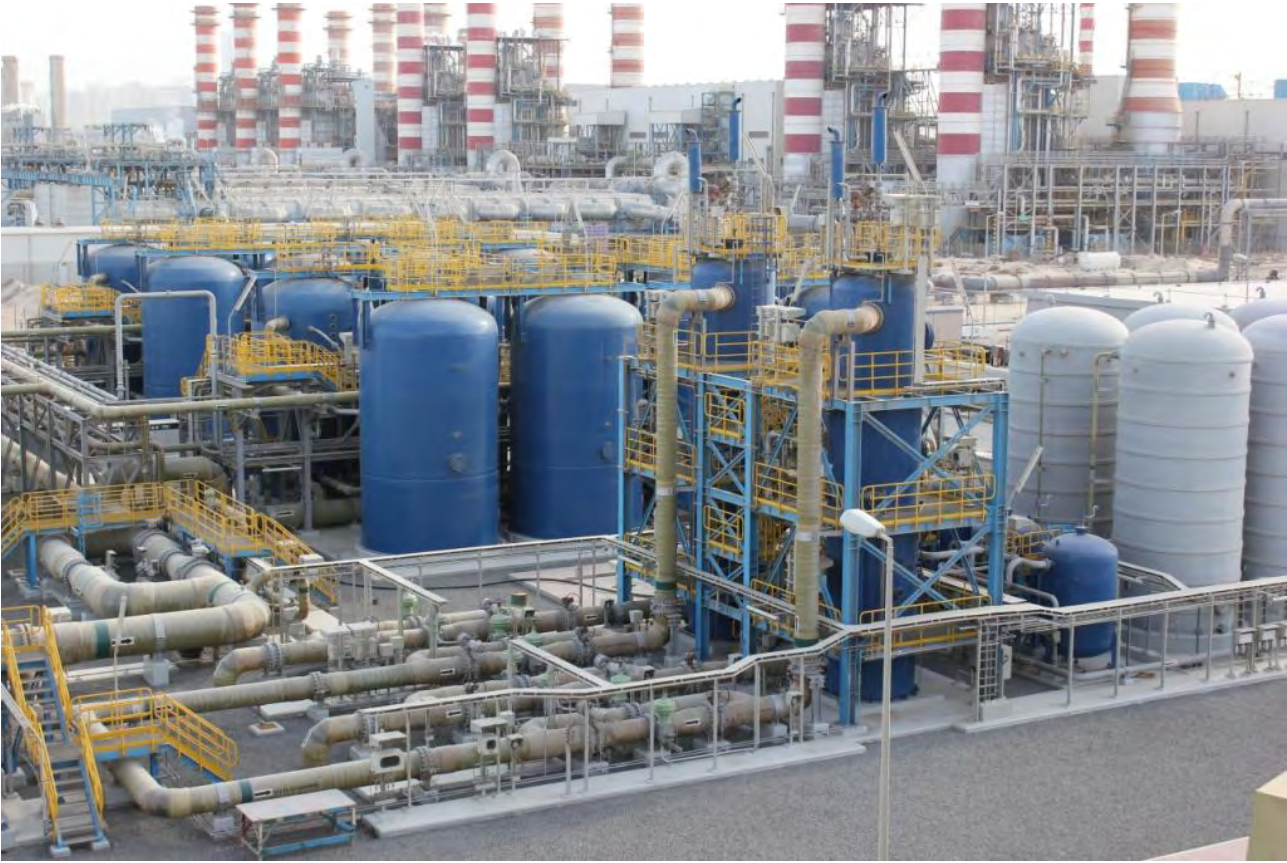
Jebel Ali M Station – Dubai (UAE) Impianto di Remineralizzazione
